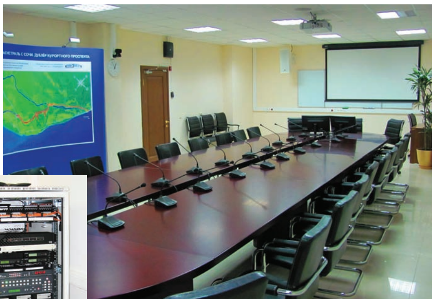
Зал совещаний, оснащенный презентационной системой на базе оборудования Kramer Electronics
